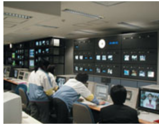
東経110°CS放送 (当社 小山台オペレーションセンター)
