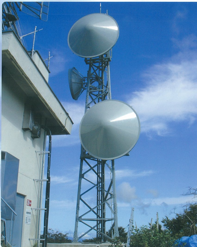
山形・新庄デジタル中継放送所TTL回線用14m iD鉄塔
